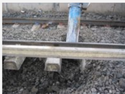
Situasjonen er alvorlig og kan gå ut over driften av T-banen
